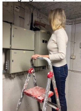
Undercentralen målades av en boende
